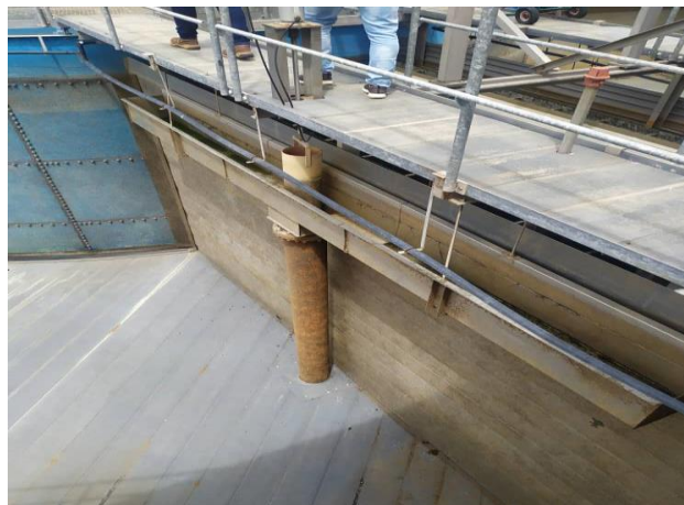
Vista de vertedero para la recolección y descarga de natas en Modulo de Flotación
