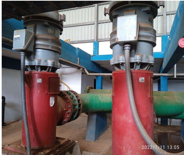
Bombas de Lavado en sistema D
