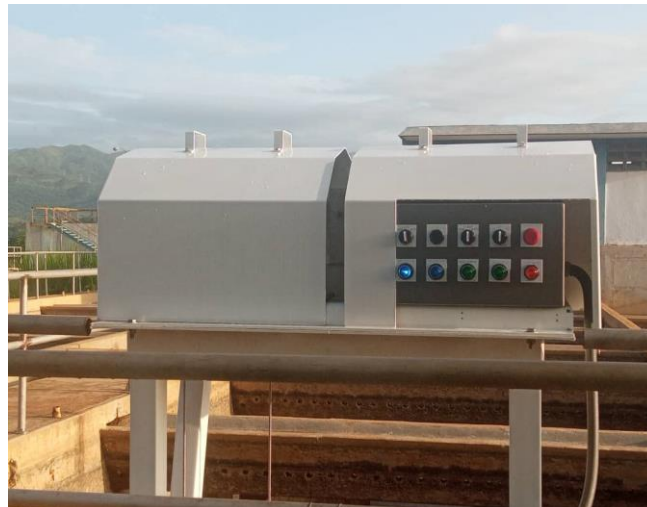
Panel de control de los Barrelos
