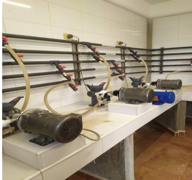
Sala de Bombas de Sulfato liquido
