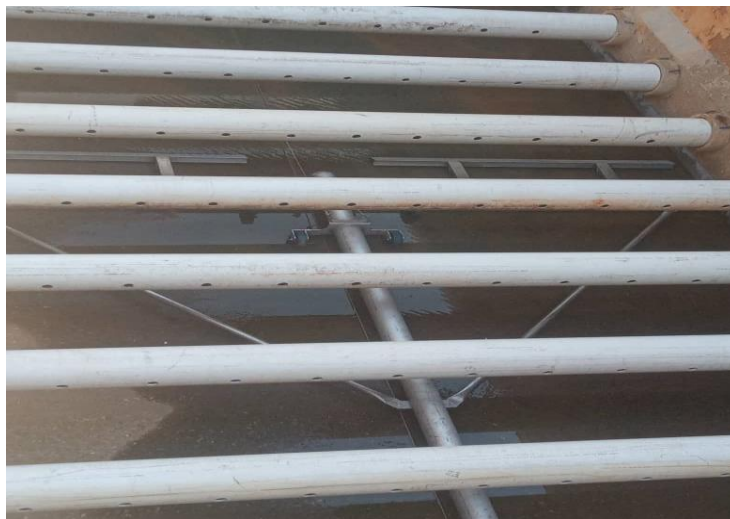
Tubos que conforman el Barrelo del Sedimentador # 1
