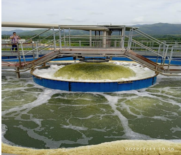
Módulo de Flotación, entrada de agua
