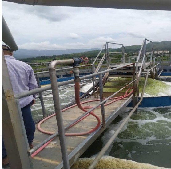
Entrada de agua cruda al Módulo de Flotación
