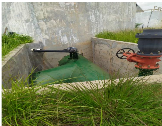
Entrada de agua clarificada al Desarenador
