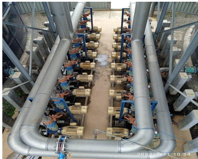
Bombas de saturación DAF
