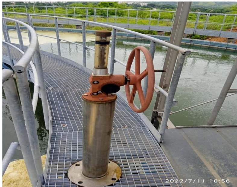
Válvulas de drenaje manual telescópica
