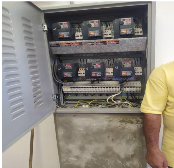
Panel de control en sala de Bombas
