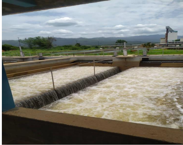
Lavado de filtros
