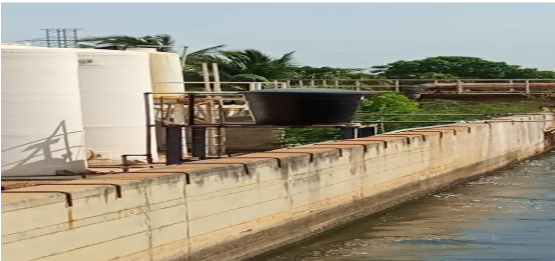
TANQUES ALMACENAMIENTO DE SULFATO DE ALUMINIO DILUIDO
