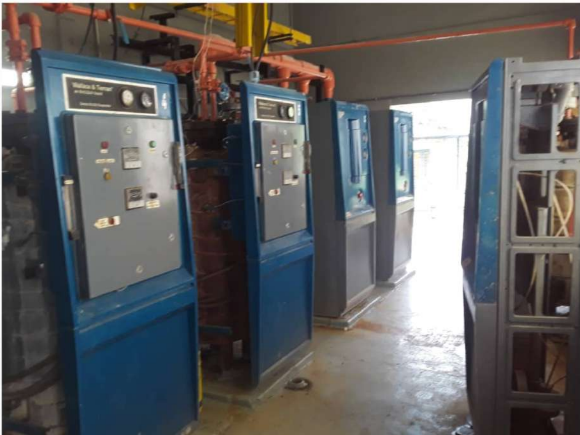
Sala de cloradores
