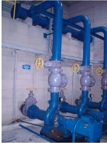
Bombas de recirculación
