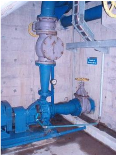
Bomba de servicio
