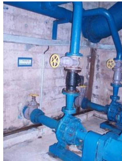
Bomba de Cloración
