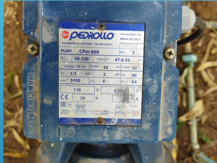
Bomba que se utiliza para recolectar la muestra y para la caseta de dosificación de sulfato liquido.
