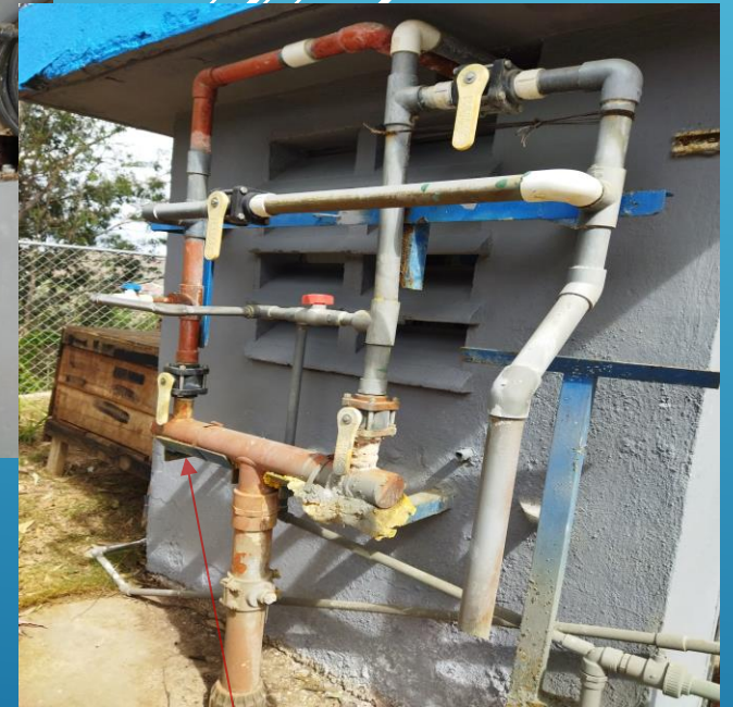
Manifold de medición por aforo de la dosificación de sulfato de aluminio líquido.
