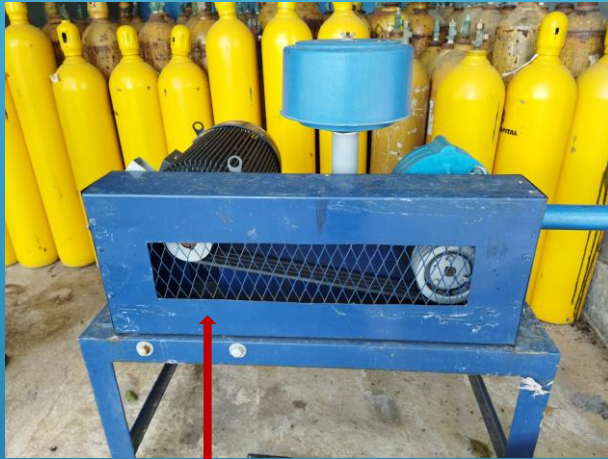
Compresor de Aire
