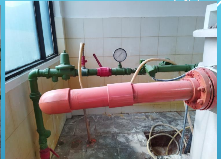
Manifold de entrada de agua (tubería color verde) y salida de la dosificación de sulfato de aluminio sólido (tubería de color anaranjado)
