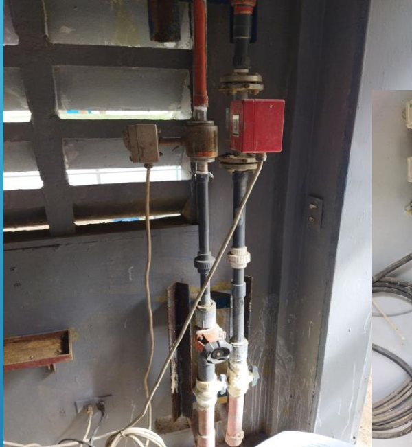
Entrada de caseta de instrumentación de agua cruda
