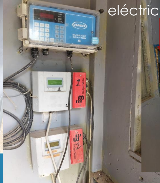
Medidores digitales para la dosificación de sustancias químicas: sulfato de aluminio líquido.
