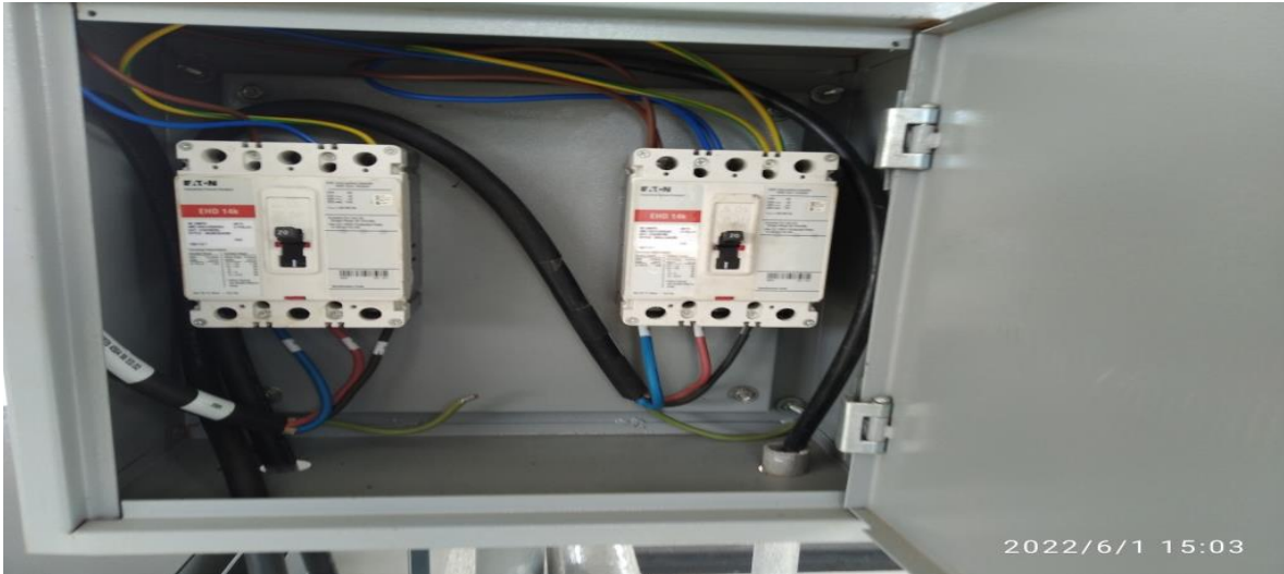
Breaker de compresores.
