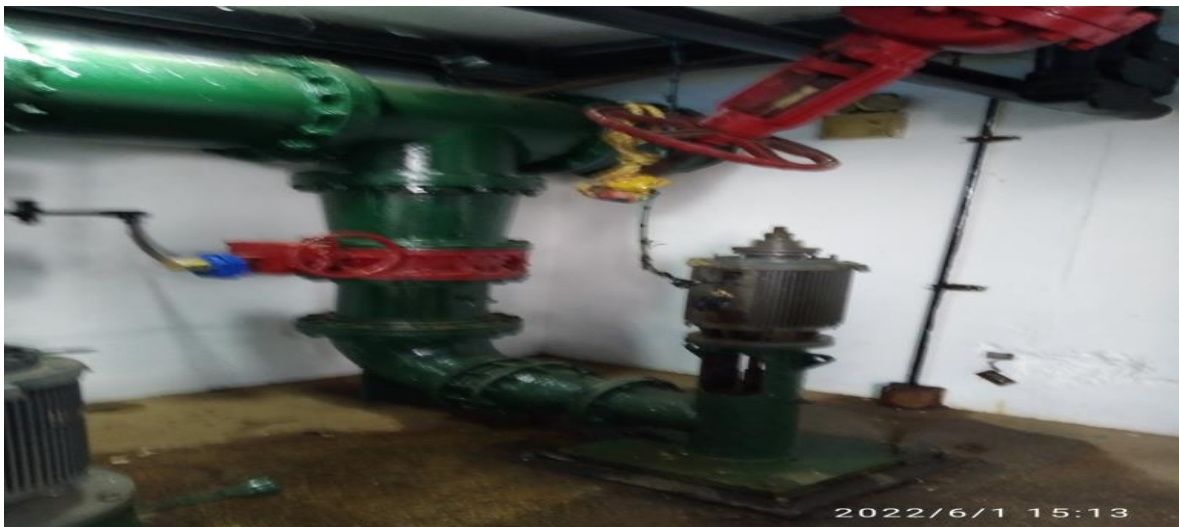
Bomba de Llenado del Tanque de Lavado de Filtros.
