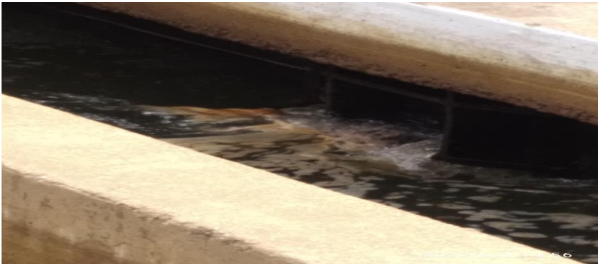
Compuerta de entrada de agua al filtro totalmente abierta.
