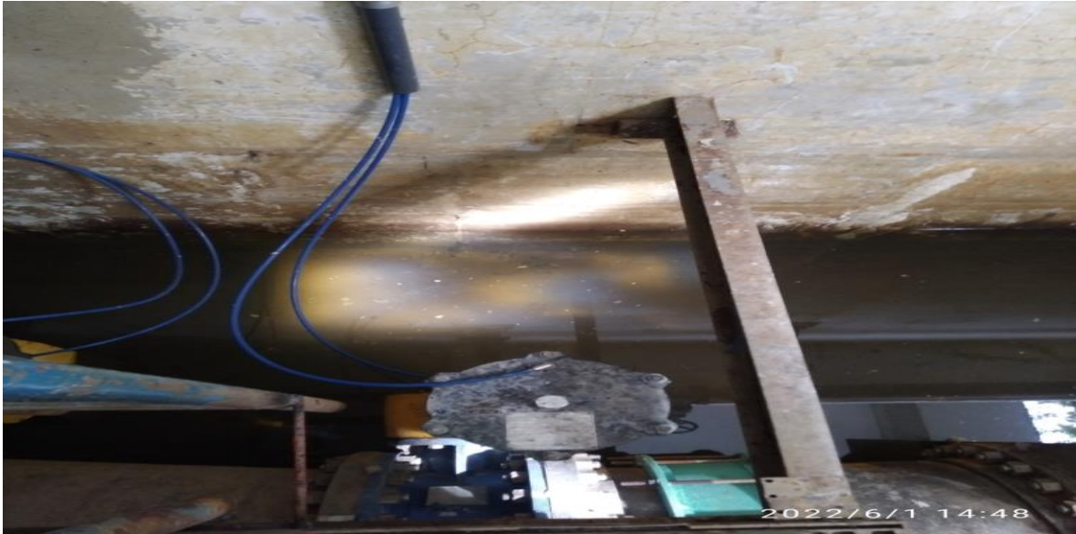
Válvula de entrada de agua de lavado a la galería.
