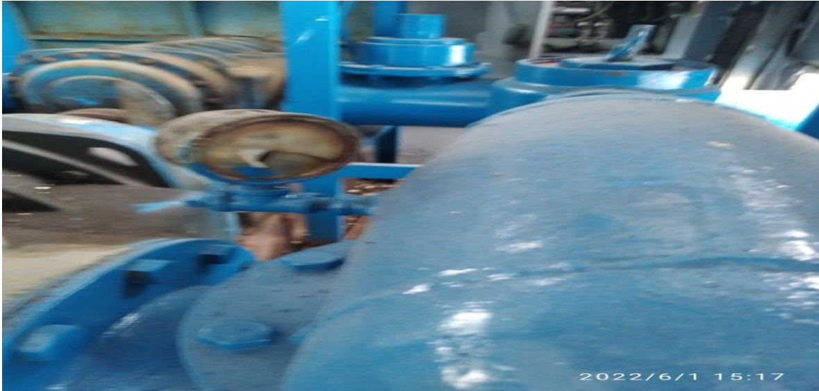
Medidor de flujo de aire. (No Operativo).
