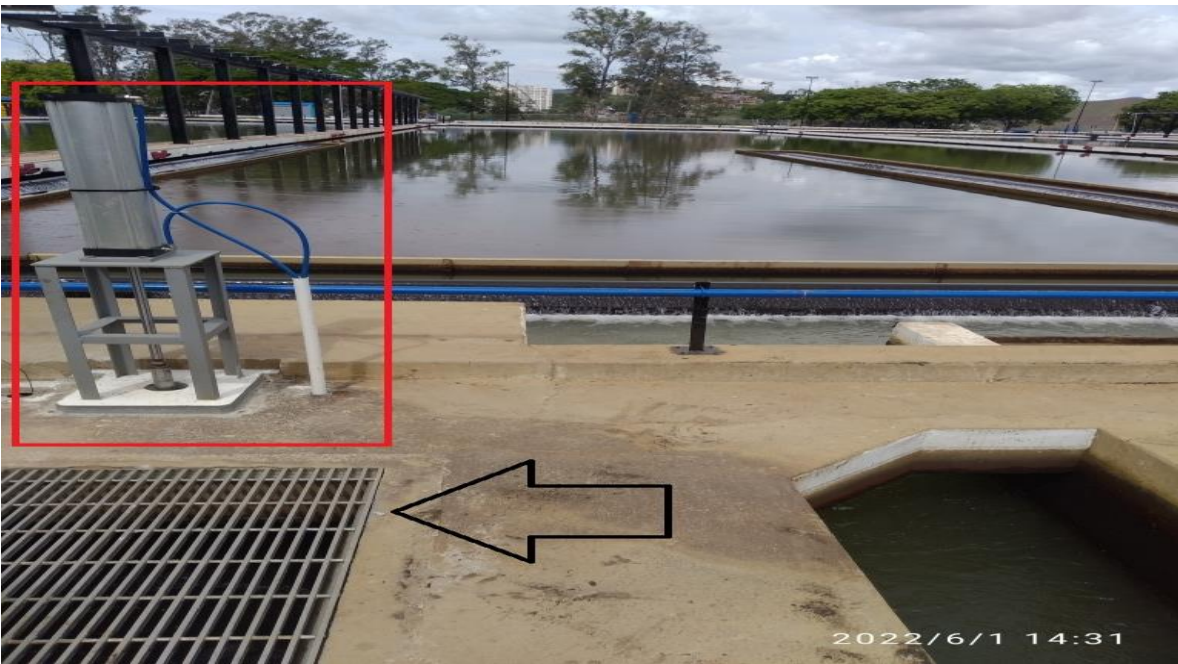
Entrada de agua a la galería demarcada por la flecha y el actuador de la válvula de entrada demarcado por el cuadro rojo.
