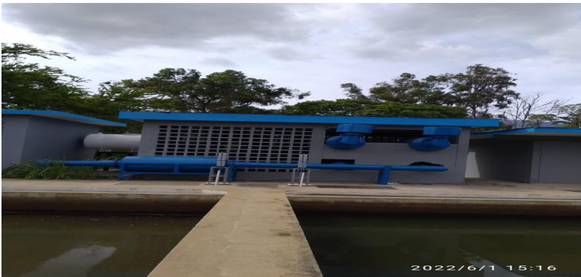
Cuarto de Sopladores.
