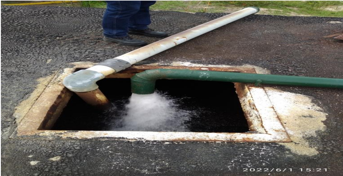
Entrada de Agua al Tanque de Lavado de Filtros.
