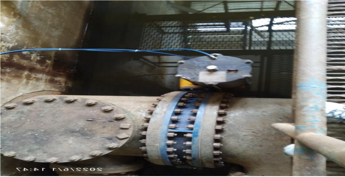
Válvula de entrada de Agua de Lavado al Filtro.
