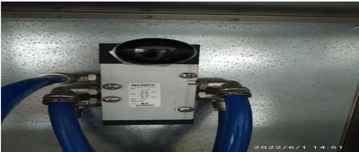
Valvula Principal de Lavado de Filtros.
