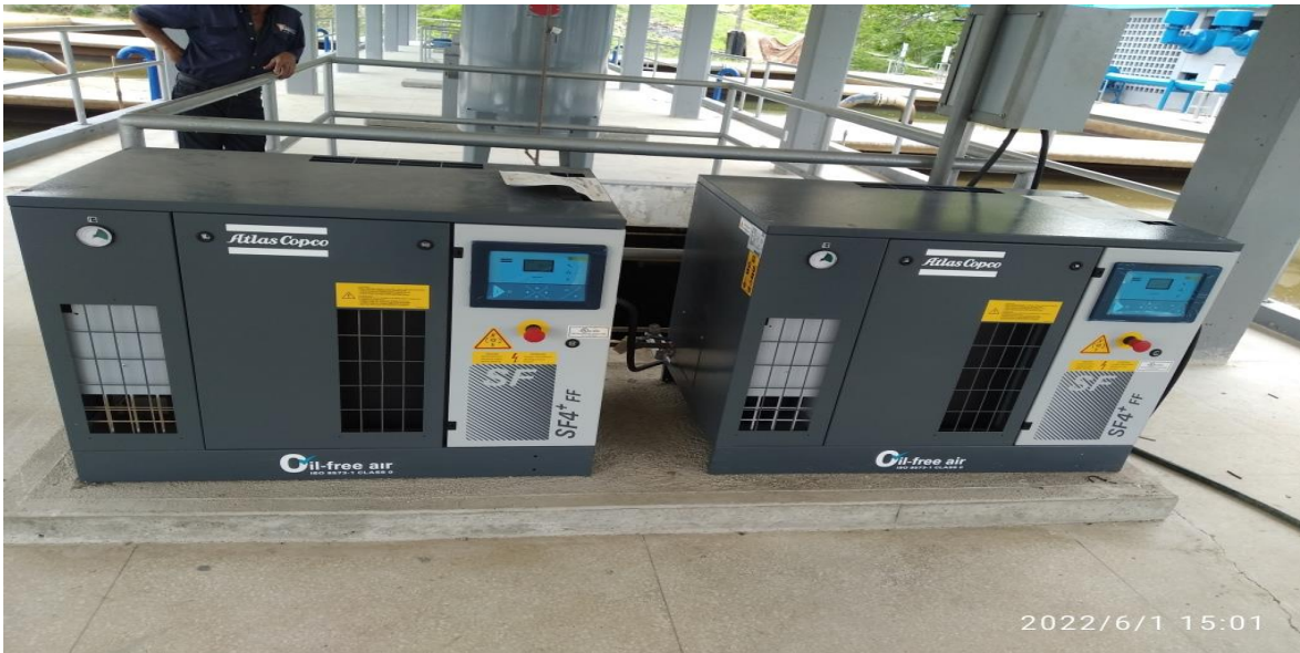
Compresores de aire.
