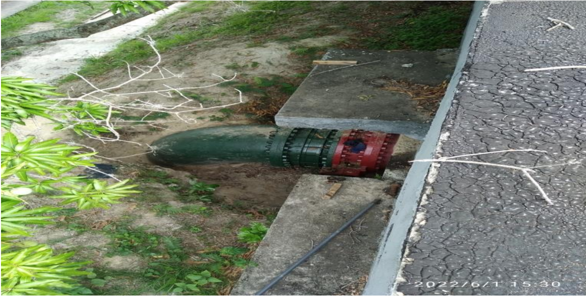
Salida de Agua del Tanque de Lavado de Filtros. ( una por cada galería).
