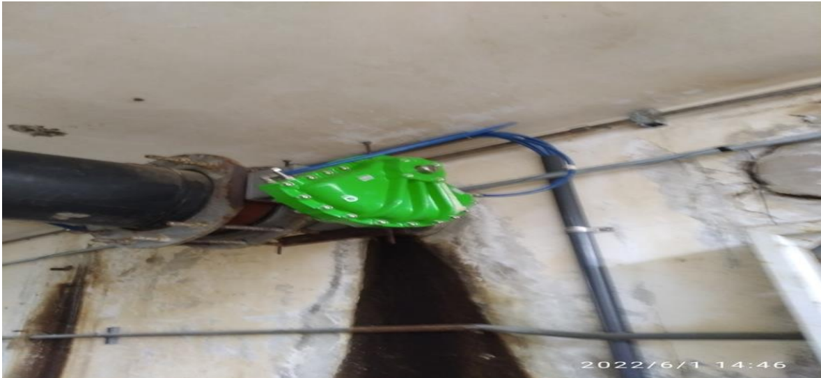
Válvula neumática de apertura y cierre del aire de Lavado.
