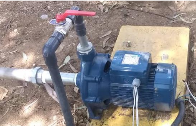
Bomba de agua cruda para el sistema de riego
