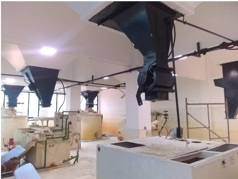
Dos sistemas de sulfato sólido (1 sistema operativo el otro inoperativo) y 4 sistemas de Cal (los 4 sistemas inoperativos).
