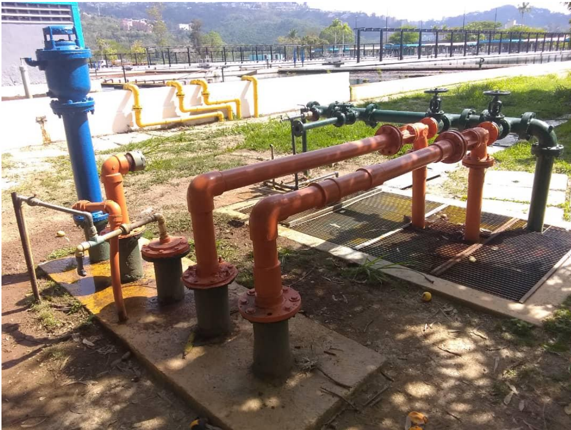
Punto de dosificación de sustancias solidas (sulfato sólido, cal y PAC)
