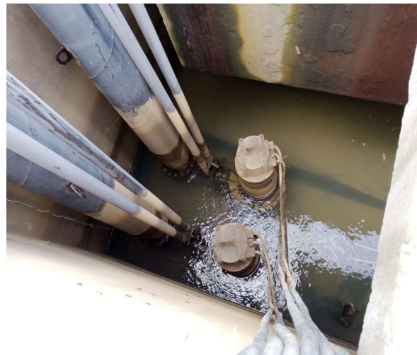
Fig. 21. Bombas de Recirculación.
