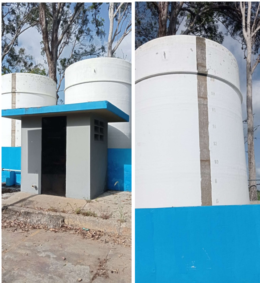
Fig. 15. Tanque de almacenamiento de Policloruro de Aluminio
