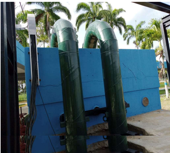
Fig. 20. Tuberías de bomba de Recirculación.
