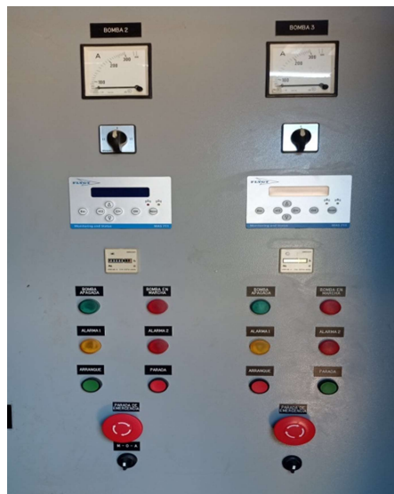
Fig. 21. Panel de control bomba de recirculación.
