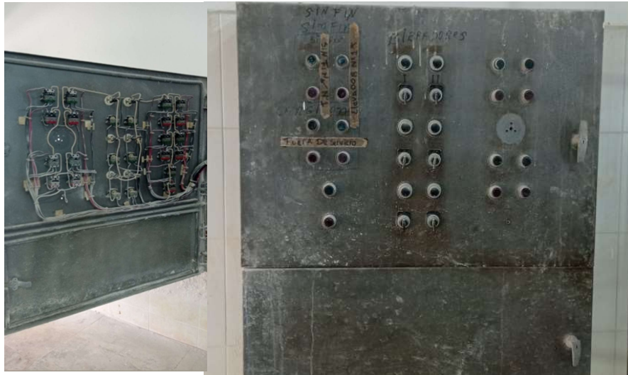
Fig. 7. Panel de control para dosificadores de sulfato de aluminio y cal
