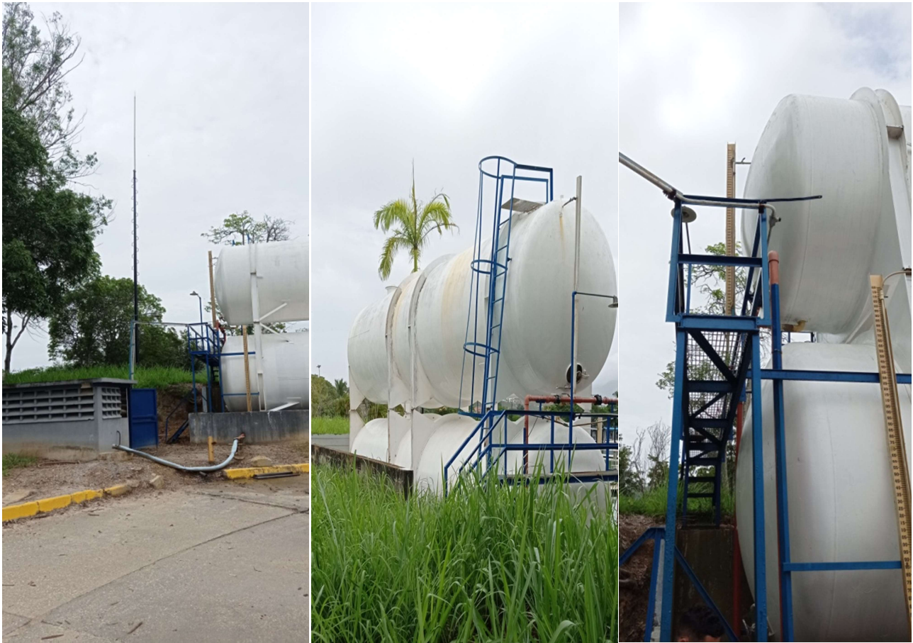
Fig. 14. Tanque de almacenamiento de sulfato líquido
