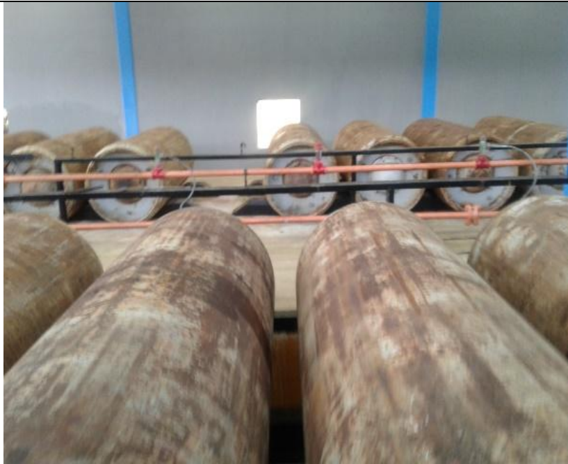
Ventilación lateral sin extractor
