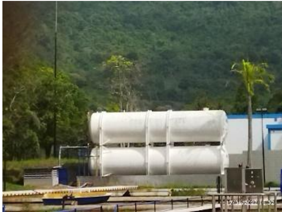
Almacén de sulfato líquido.
