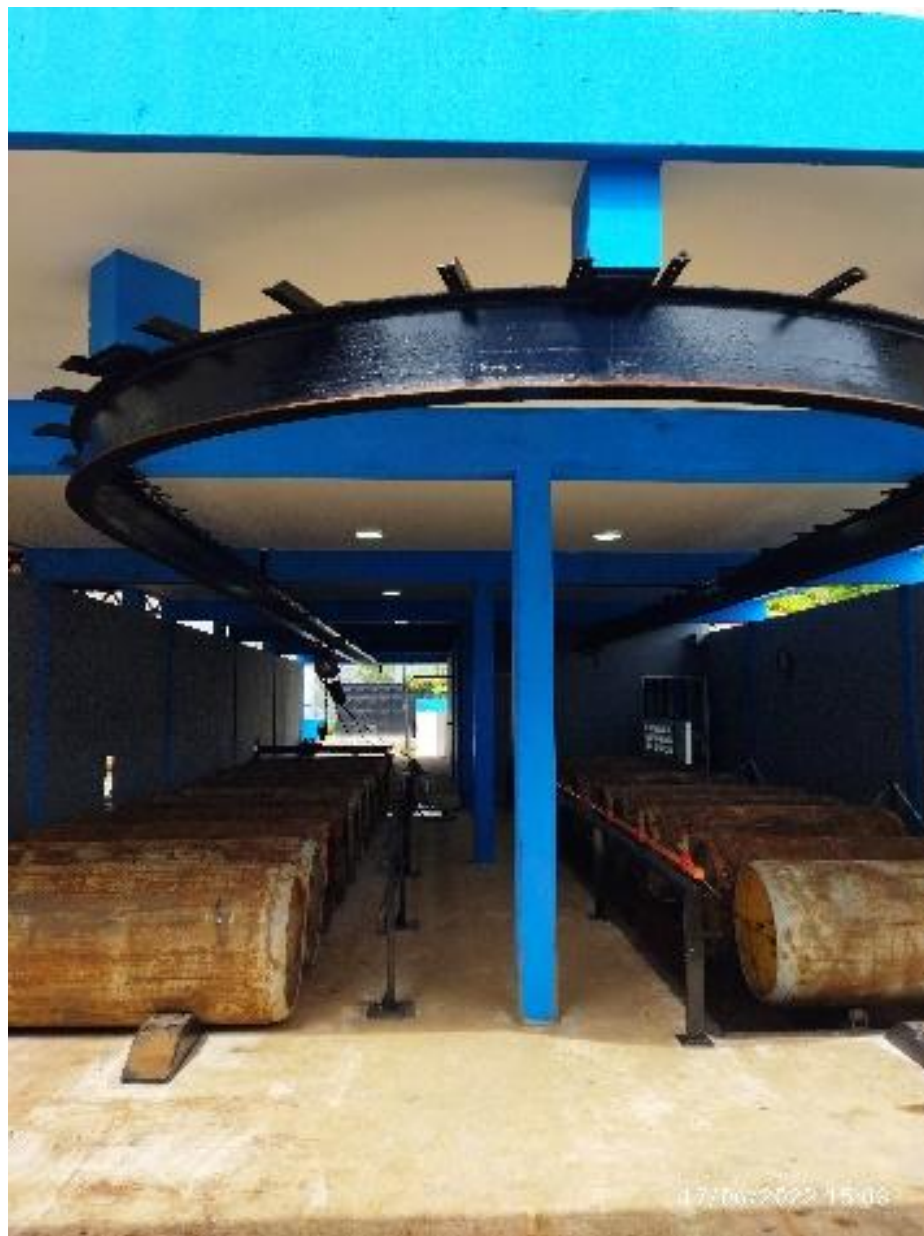
Almacen de cilindros de cloro.
