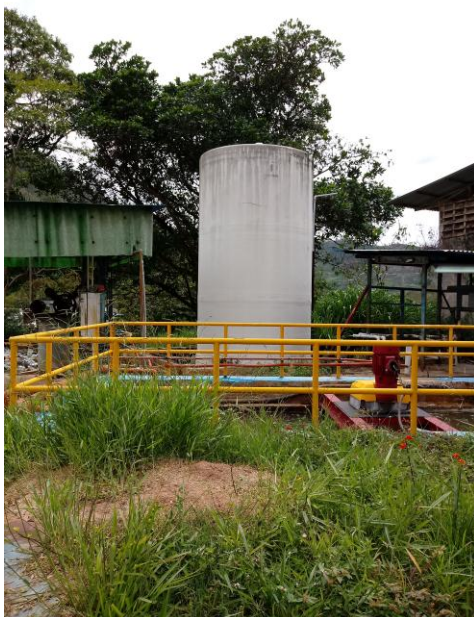
NRO 3 TANQUE PARA UTILIZAR POLICLORURO DE ALUMINO ACTUALMENTE FUERA DE SERVICIO
