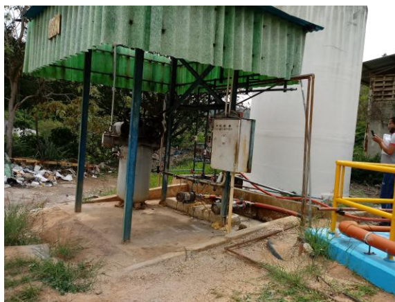
NRO. 4 TABLERO PARA CONTROL DE DOSIFICACIÓN DE SULFATO DE ALUMINIO LÍQUIDO
