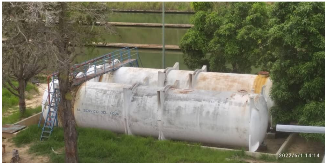
TANQUES CILINDRICOS PARA ALMACENAMIENTO DE SULFATO DE ALUMINIO LÍQUIDO
