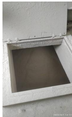
PARTE DE ARRIBA DE LAS TOLVAS DONDE SE COLOCA EL SULFATO DE ALUMINIO LIQUIDO
