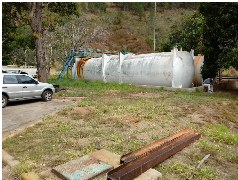
Nro. 6 TANQUES CILINDRICOS PARA ALMACENAMIENTO DE SULFATO DE ALUMINIO LÍQUIDO
