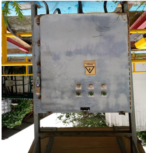
NRO. 2 TABLERO PARA CONTROL DE LAS UNIDADES DE MEZCLA RÁPIDA
