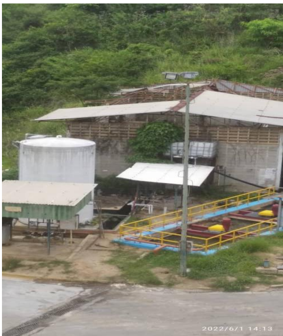
UNIDAD DE MEZCLA RAPIDA VISTA AEREA1
