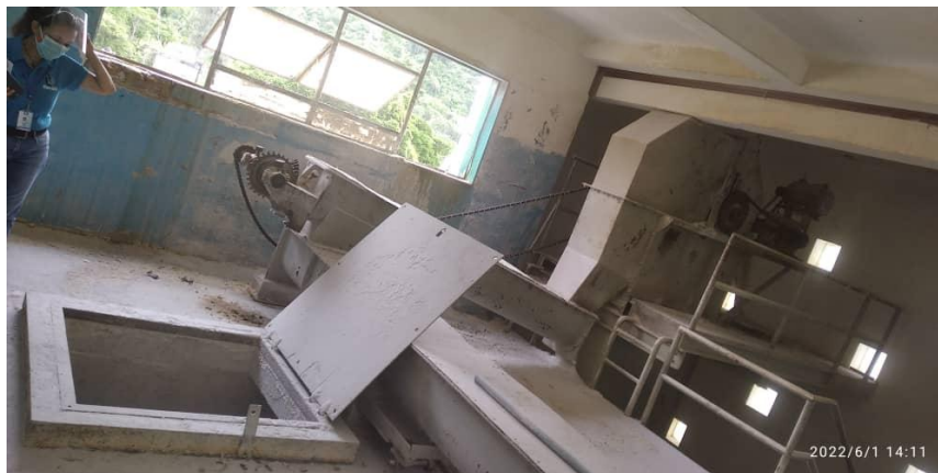
PARTE DE ARRIBA DE LAS TOLVAS DONDE SE COLOCA EL SULFATO DE ALUMINIO SÓLIDO
