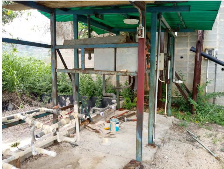
NRO. 5 INSTALACIONES QUE FUERON UTILIZADAS AÑOS ATERIORES PARA LA INYECCIÓN DE POLICLORURO DE ALUMINIO ACTUALMENTE FUERA DE SERVICIO
