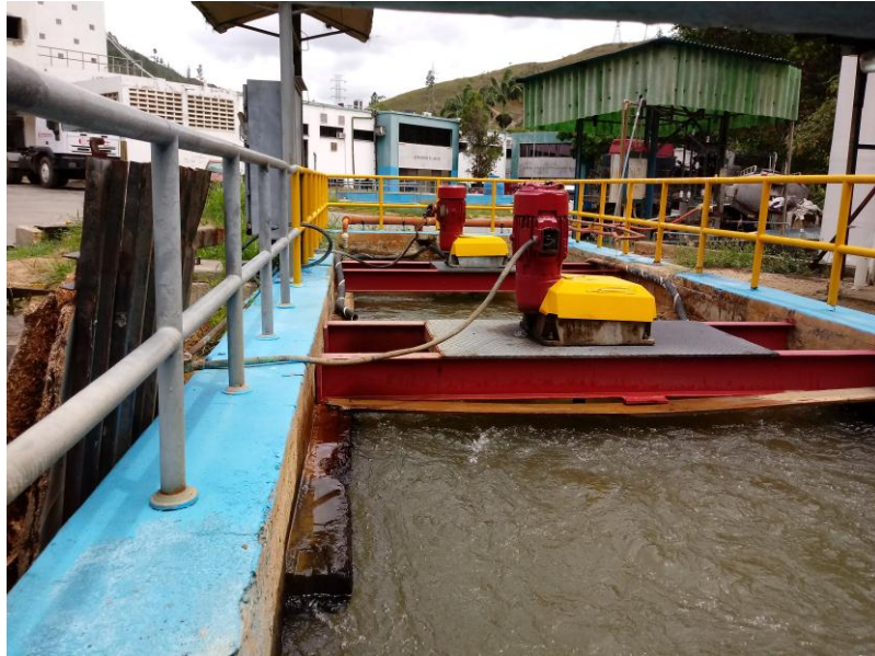
NRO. 1 UNIDAD DE MEZCLA RÁPIDA Obsérvese los dos mezcladores mecánicos (UNA UNIDAD SE ENCUENTRA FUERA DE SERVICIO)
