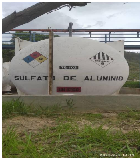
VISTA FRONTAL TANQUES PARA ALMACENAMIENTO DE SULFATO DE ALUMINIO LIQUIDO
