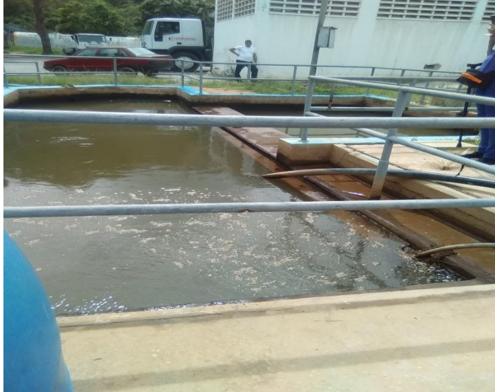
Tanquilla de entrada
