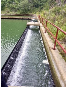
Vertedero al final de la floculación de lodos
