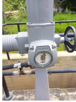
Actuador de la tanquilla de sedimentación de lodos
