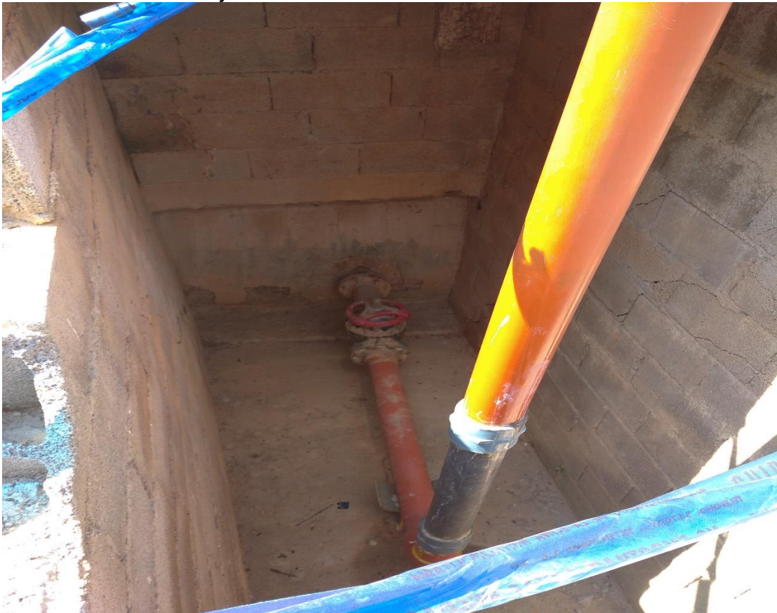
Inyección de Cloro Gas “Precloracion”
